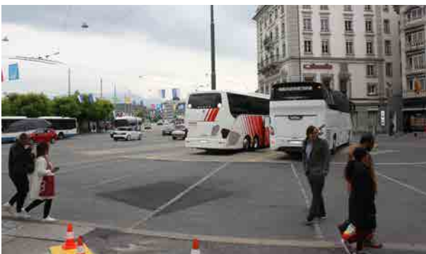
Belagsschäden, verstellt durch Carhalteplätze
