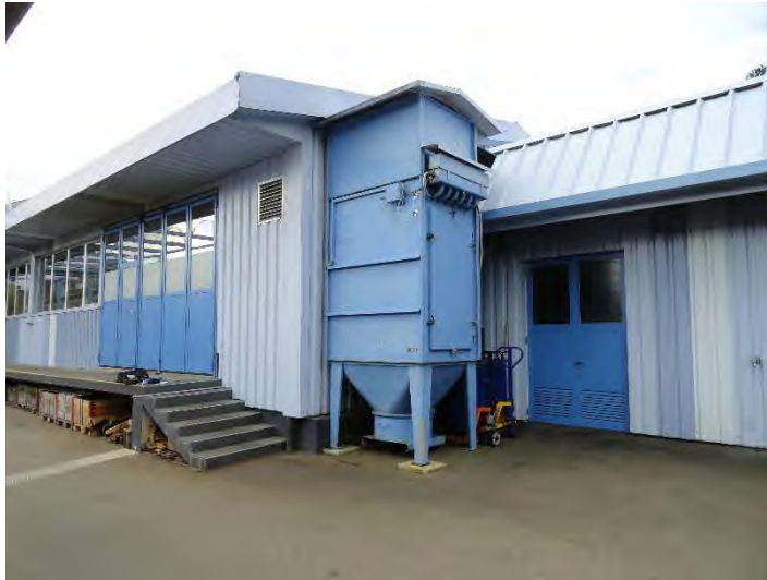
Abb. 24 Filteranlage Jost AG (planteam 21.10.2016)
