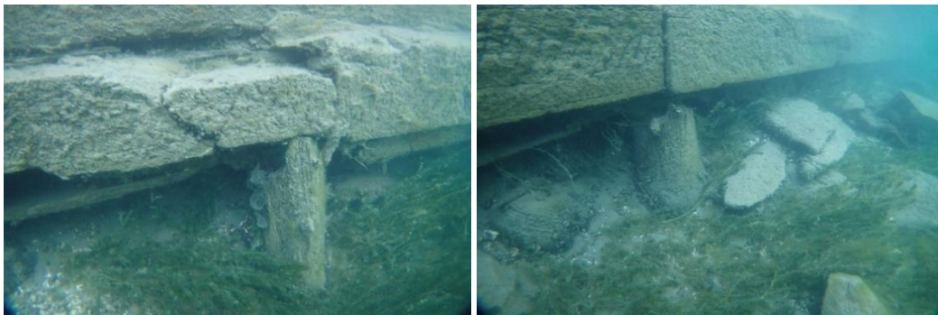
Abb. 22 und 23: Unterspülte Reussufermauer
