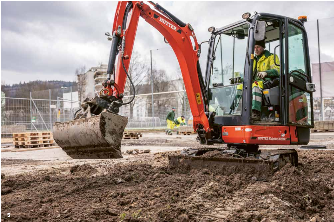
3 Die Pflege- und Unterhaltsarbeiten der öffentlichen Grünflächen sind vielfältig. 4 Bepflanzen von Blumenrabatten. 5 Bauliche Unterhaltsarbeiten.
