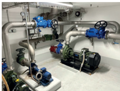
Blick in den Pumpenkeller mit den Pumpen für den Betrieb der grossen und kleinen Fontänen. Foto: ewl
