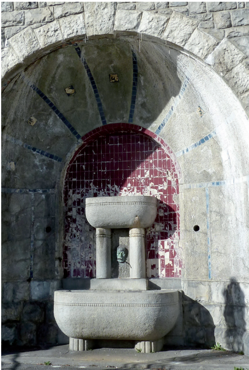
Der repräsentative Nischenbrunnen des Schulhauses St. Karli im Zustand vor der Sanierung im Jahr 2022. Die Wandnische ist mit keramischen Kacheln und Tierdarstellungen reich ausgeschmückt.
