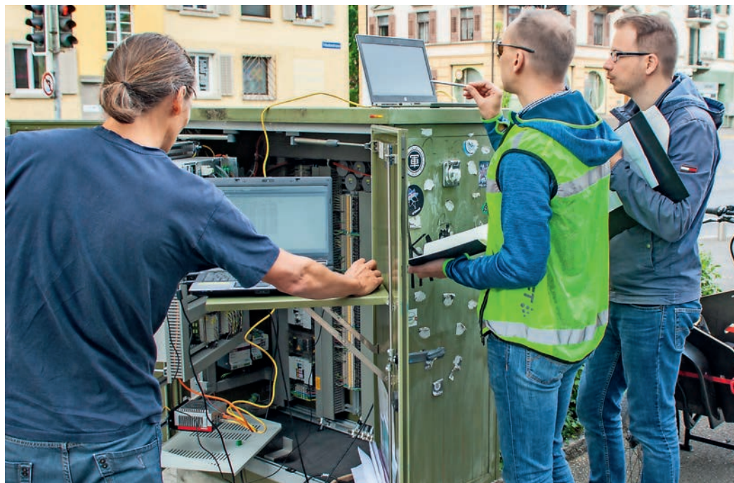
7 | Erst-Inbetriebnahme der Selbst-Steuerung. 7 | Première mise en service de l'autorégulation.
