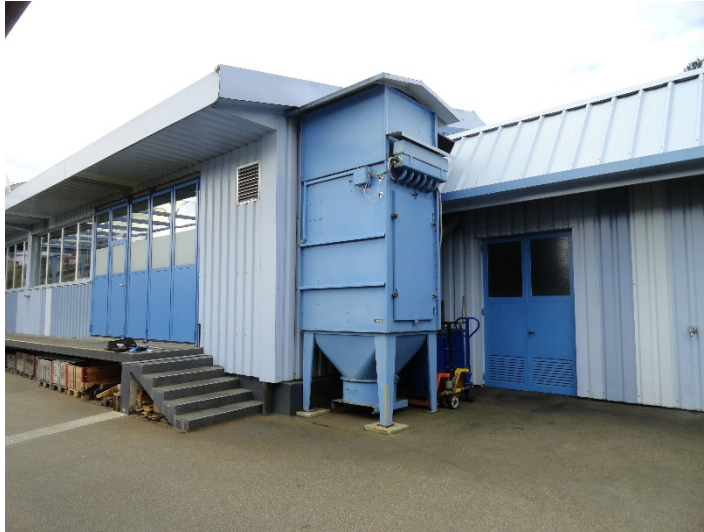
Abb. 24 Filteranlage Jost AG (planteam 21.10.2016)
